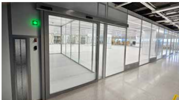
Die gesamte Anlage umfasst mehr als 750 Quadratmeter Reinraumfläche und ist für Erweiterungen ausgelegt
