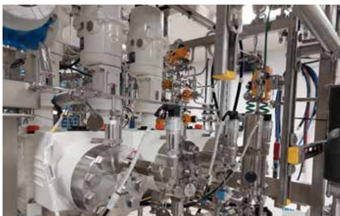
Das Schweizer Technologieunternehmen Bachem hat bereits Pumpen im hygienic-Design vom Pumpenhersteller LEWA im Einsatz. Bild: BACHEM
