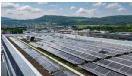
Endress+Hauser hat auf den Dächern vieler Büro- und Produktionsgebäude Solaranlagen installiert.
